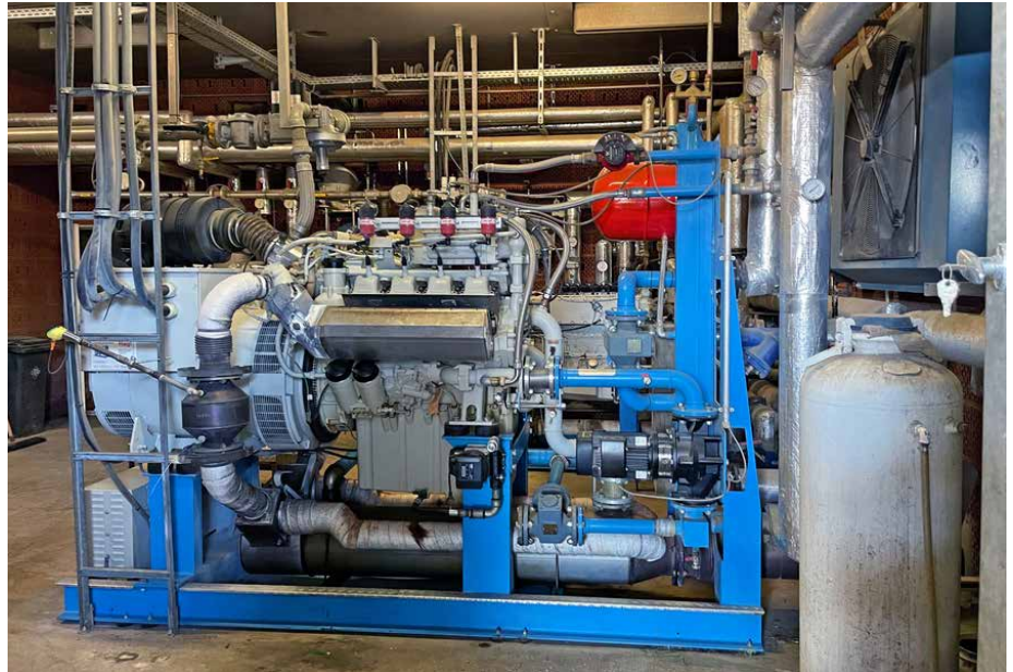
Bei den gemessenen Werten der Abgasreinigungsanlage von Biogas Fond, benötigt das Biogas-BHKW von Landwirt Hussel keine AdBlue-Anlage und keinen Katalysator mehr.
