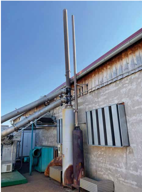
Am Ende des Prozesses wird das entstandene Reingas über den Schornstein abgegeben.
